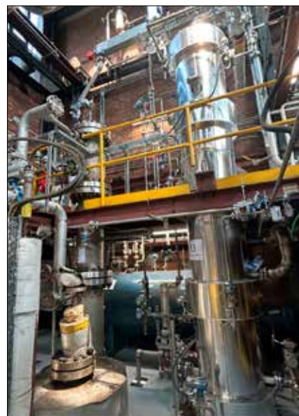
Fig. 5 - PiCaSSo-pilootinstallatie (1000 Nm³/h) voor CO 2 -afvang door absorptie
