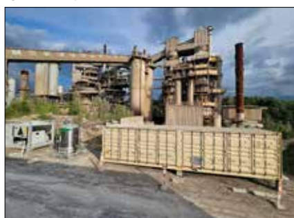
Fig. 2 – Pilote de capture CO 2 cryogénique anti-sublimation (installé sur un site de production de chaux)
